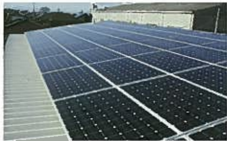
Sマンション (15kW) / 埼玉県本庄市
